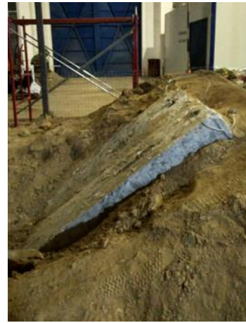
(d) Damaged slabs to be replaced
