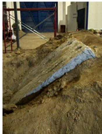
(d) Damaged slabs to be replaced
